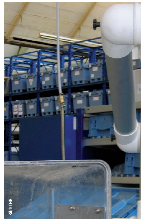
Ein beweglicher Absaugarm mit großer Haube an einem weiteren Arbeitsplatz ermöglicht die flexible Umsetzung anderer Klebeaufgaben.
